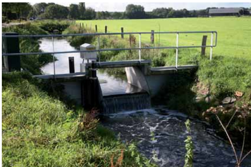
Automatische stuw in Ashorstersloot, vlakbij de ingang van De Bruuk aan de Ashorst
